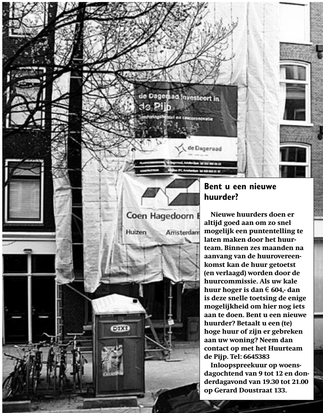
De bewuste woning aan de Daniel Stalpertstraat op het moment waarop de renovatie nog in volle gang was.
